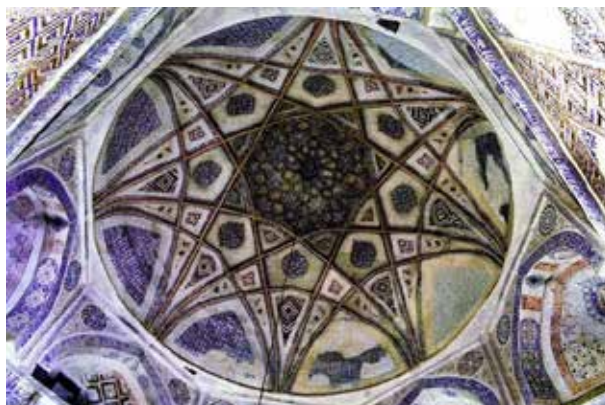
تصویر شماره ۷: رسمی هشت و... زیر گنبدخانه مجموعه آرامگاهی شیخ احمد جامی تربت جام آستان خراسان رضوی (دوره تیموری)؛ مأخذ: کتاب مزار شیخ احمد جام، تالیف: مهندس فرامرز صابرمقدم
