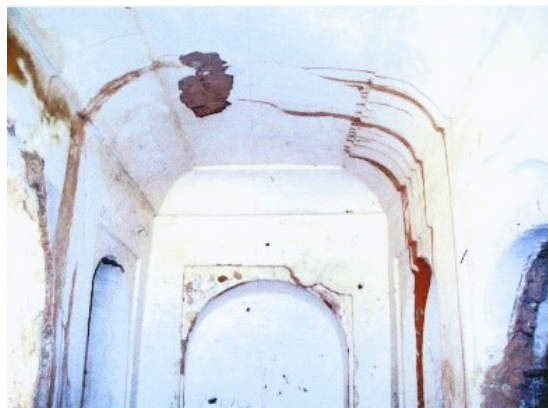
تصویر شماره ۹: سقف اتاق تابستان‌نشین، خانه باغ فیاضی؛ مأخذ: مآخذ آرشیو تصاویر میراث فرهنگی خراسان جنوبی، ۱۳۸۴
