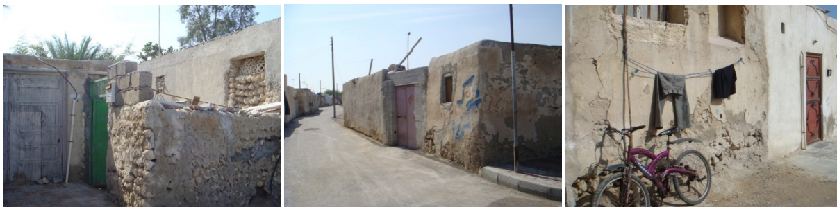
تصویر ۵: فرسودگی کالبدی شدید در محله
